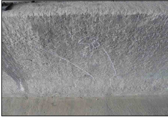
a. 공동구 S16 측면 균열(0.3mm미만)
