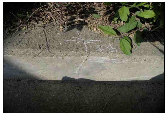
b. 종점부 도수로 균열(0.3mm 이상)
