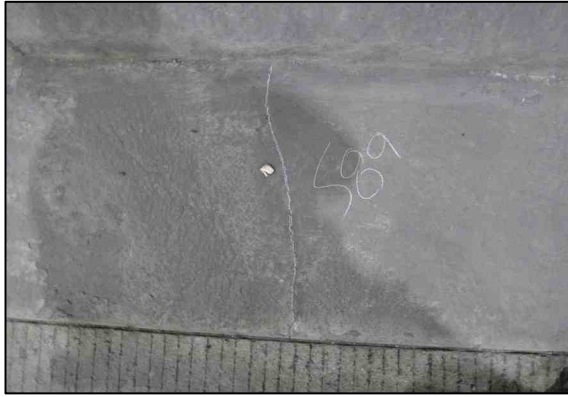
a. 측구 S89 균열(0.3mm 이상)
