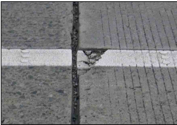
c. 포장부 S51 줄눈 주변 파손
