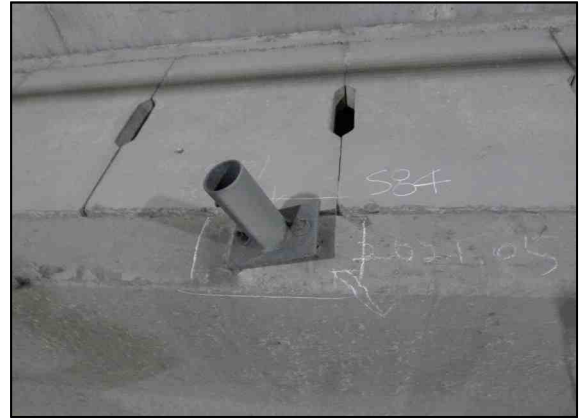
b. 난간 S84 지주 파손, 탈락
