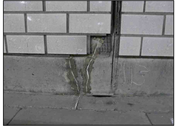
b. 측벽부 S113 좌측 타일탈락, 파손
