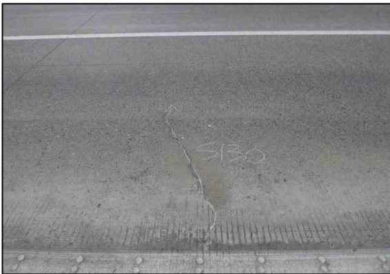
e. 포장부 S130 균열
