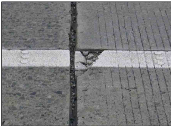
c. 포장부 S51 줄눈 주변 파손
