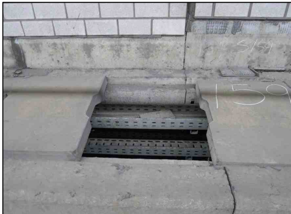
c. 공동구 S159 덮개 탈락(유실)
