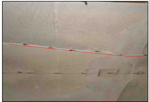
d. 천단부 S32 보수부 재균열(0.3mm미만)
