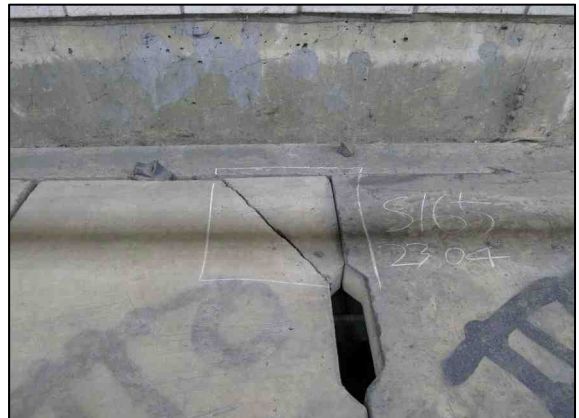
d. 공동구 S165 덮개 파손
