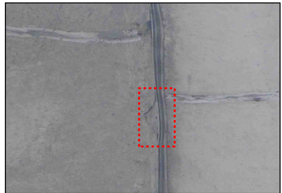
p. 천단부 S155(J155) 시공이음부 박락
