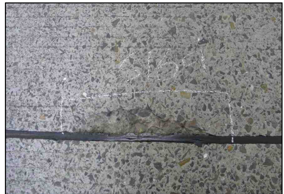
h. 포장부 S169 파손
