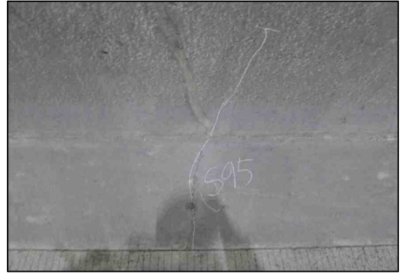
b. 측구 S95 균열(0.3mm 이상)
