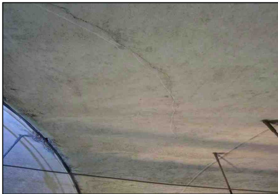
m. 천단부 S92 균열(0.3mm 미만)
