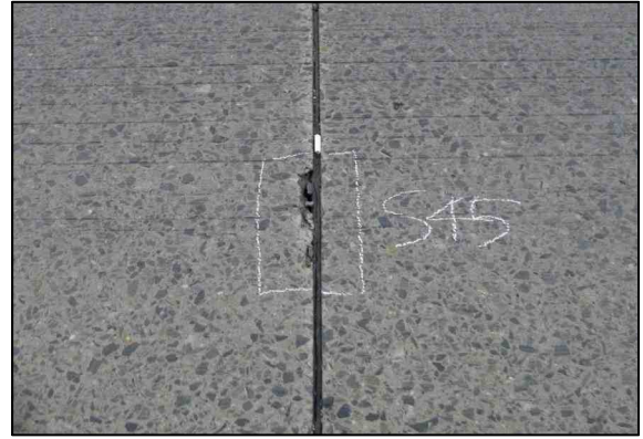
b. 포장부 S45 줄눈 주변 파손
