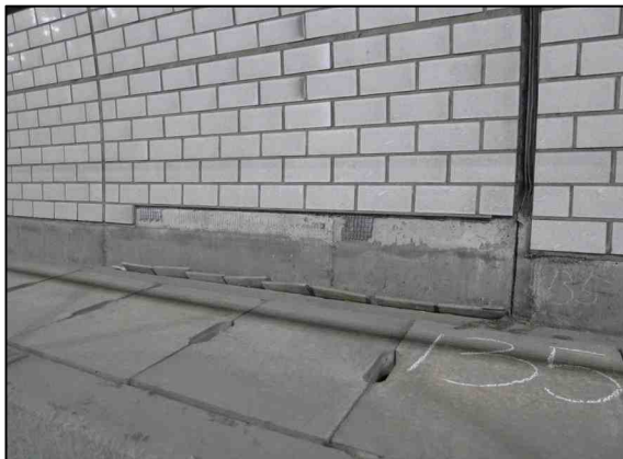
c. 측벽부 S135 좌측 타일탈락, 파손
