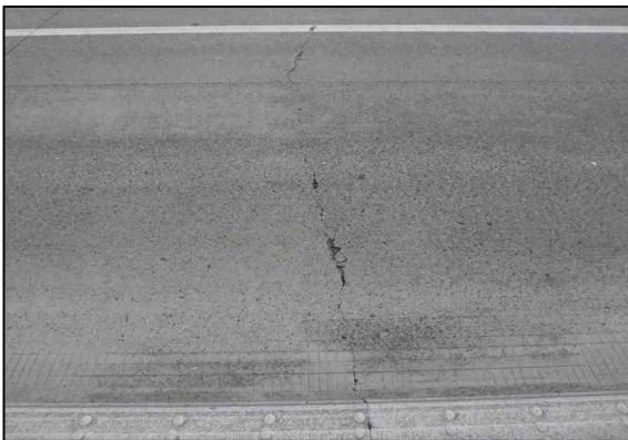
g. 포장부 S156 균열
