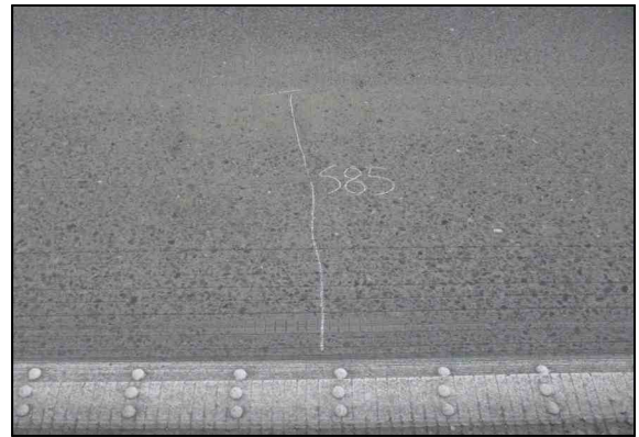
d. 포장부 S85 균열
