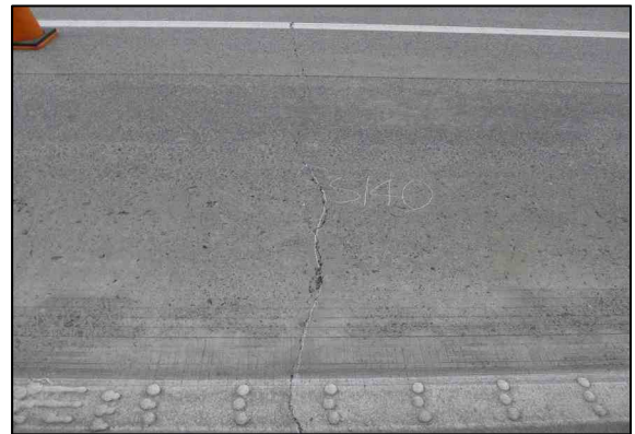
f. 포장부 S140 균열
