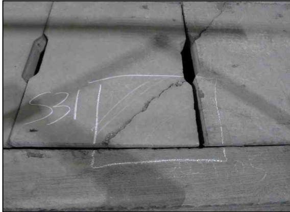
a. 공동구 S31 덮개 파손
