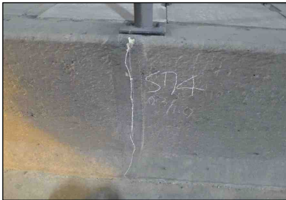
e. 공동구 S74 측면 균열(0.3mm이상)
