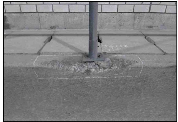
d. 공동구 S48 좌측 파손
