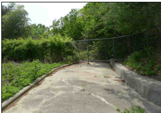
a. 시점부 소단배수로 균열(0.3mm 이상)
