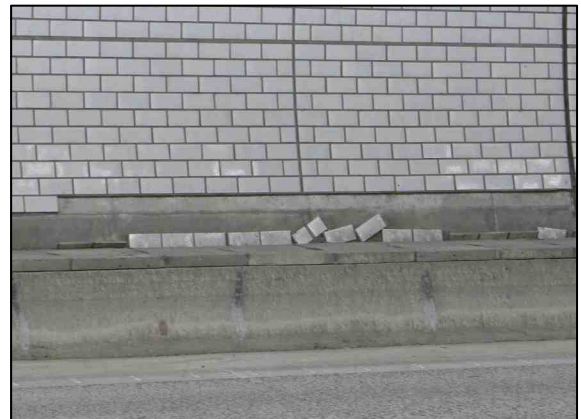
d. 측벽부 S143 좌측 타일탈락, 파손
