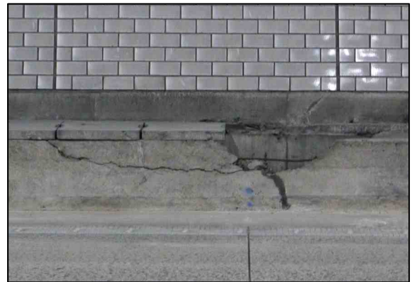
f. 공동구 S77 측면 파손, 철근노출
