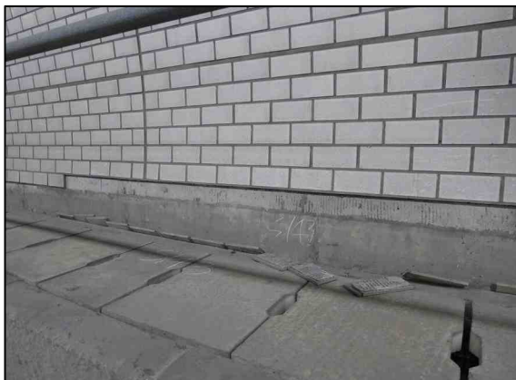
e. 측벽부 S143 우측 타일탈락, 파손
