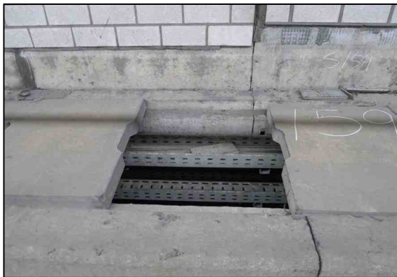
g. 공동구 S159 좌측 덮개 탈락(유실)
