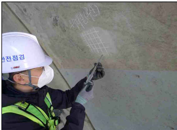
c. 탄산화깊이 측정현황
