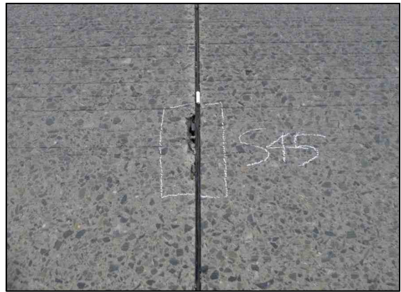
b. 포장부 S45 줄눈 주변 파손
