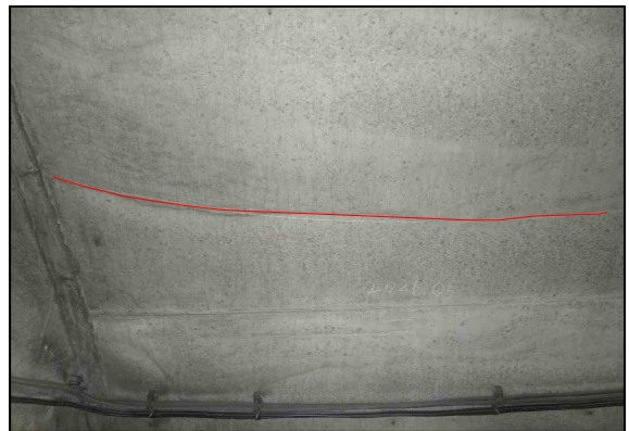
h. 천단부 S54 균열(0.3mm미만)
