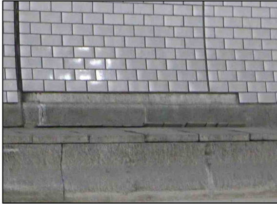
a. 측벽부 S106 우측 타일탈락, 파손
