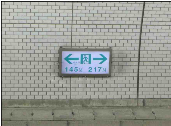
a. 비상구 표시등 설치현황
