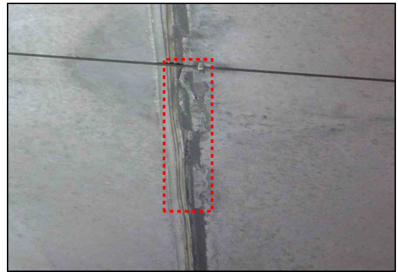
l. 천단부 S70(J70) 시공이음부 박락
