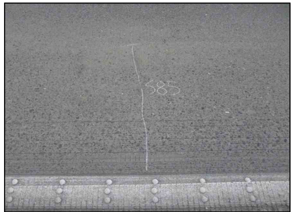
d. 포장부 S85 균열
