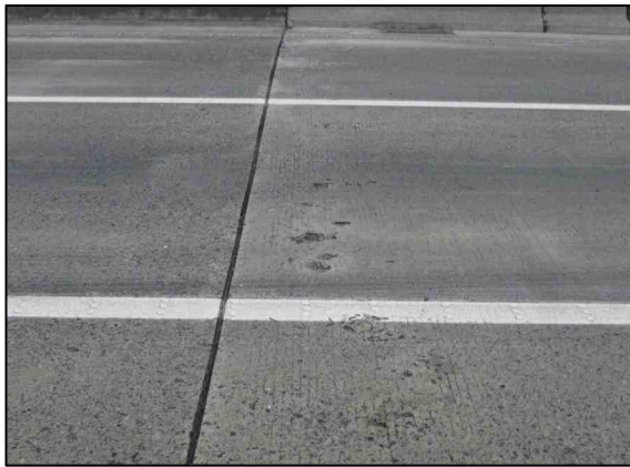
a. 포장부 S20 파손, 패임
