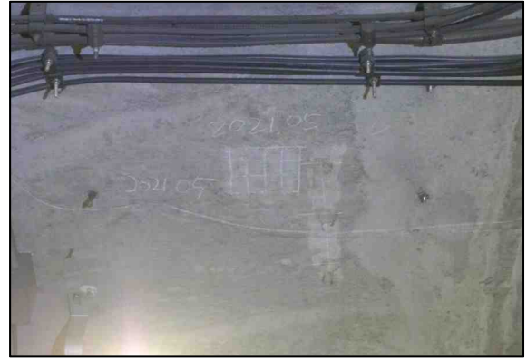
j. 천단부 S58 균열(0.3mm 이상)
