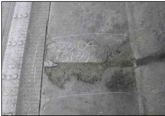
c. 측구 S137 파손
