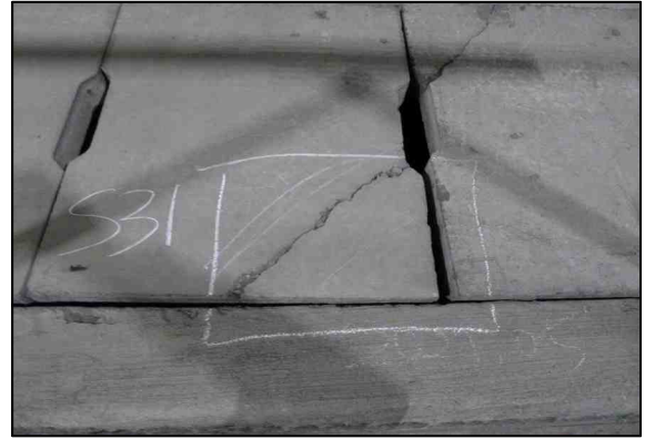
b. 공동구 S31 좌측 덮개 파손
