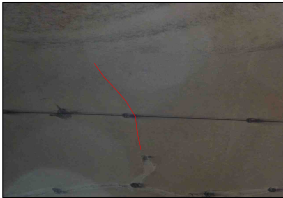
c. 천단부 S25 균열(0.3mm미만)
