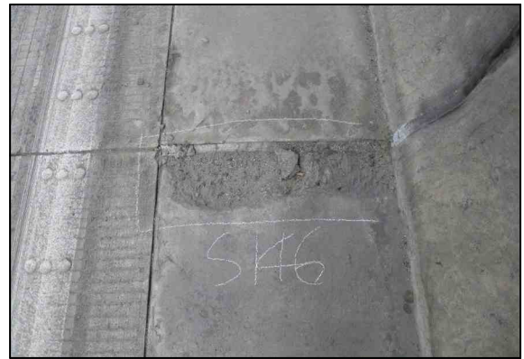
d. 측구 S146 파손
