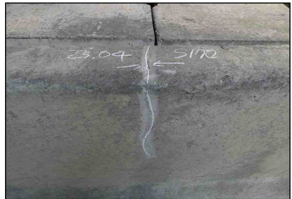
h. 공동구 S170 측면 균열(0.3mm미만)
