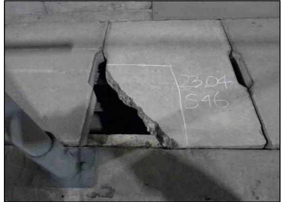
b. 공동구 S46 덮개 파손
