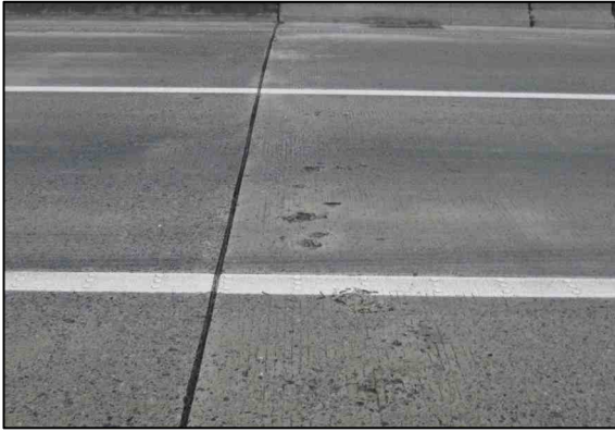
a. 포장부 S20 파손, 패임
