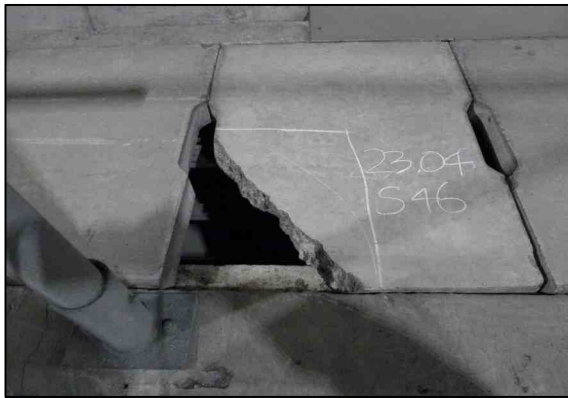
c. 공동구 S46 좌측 덮개 파손
